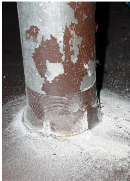
Das ausgeschnittene Rohr von innen betrachtet.
